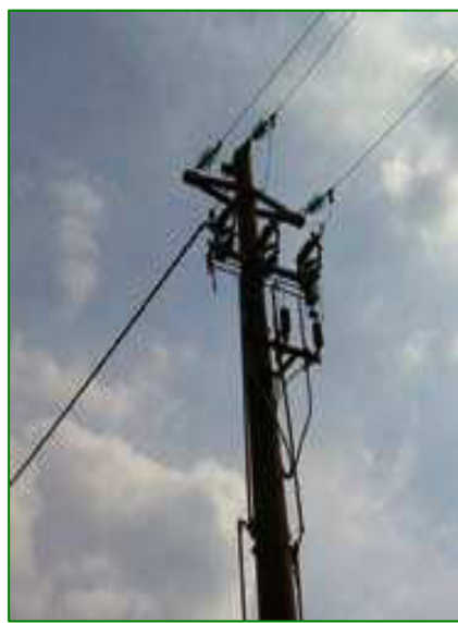
Figura 10: esempio di cabina di trasformazione MT/BT su palo.
