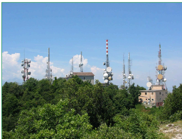
Figura 13: esempio di sito ad alta concentrazione di impianti radianti.
