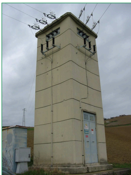
Figura 9: esempio di cabina di trasformazione MT/BT in muratura.
