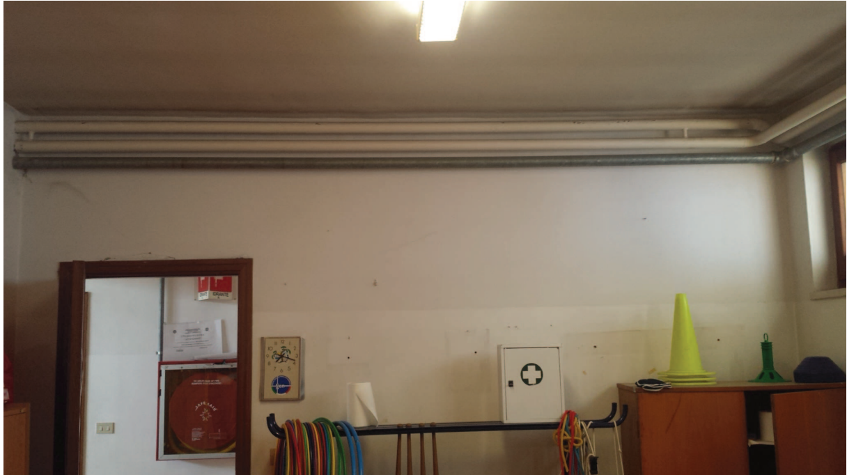
Tubazioni degli impianti a vista privi di isolamento termico negli spogliatoi
