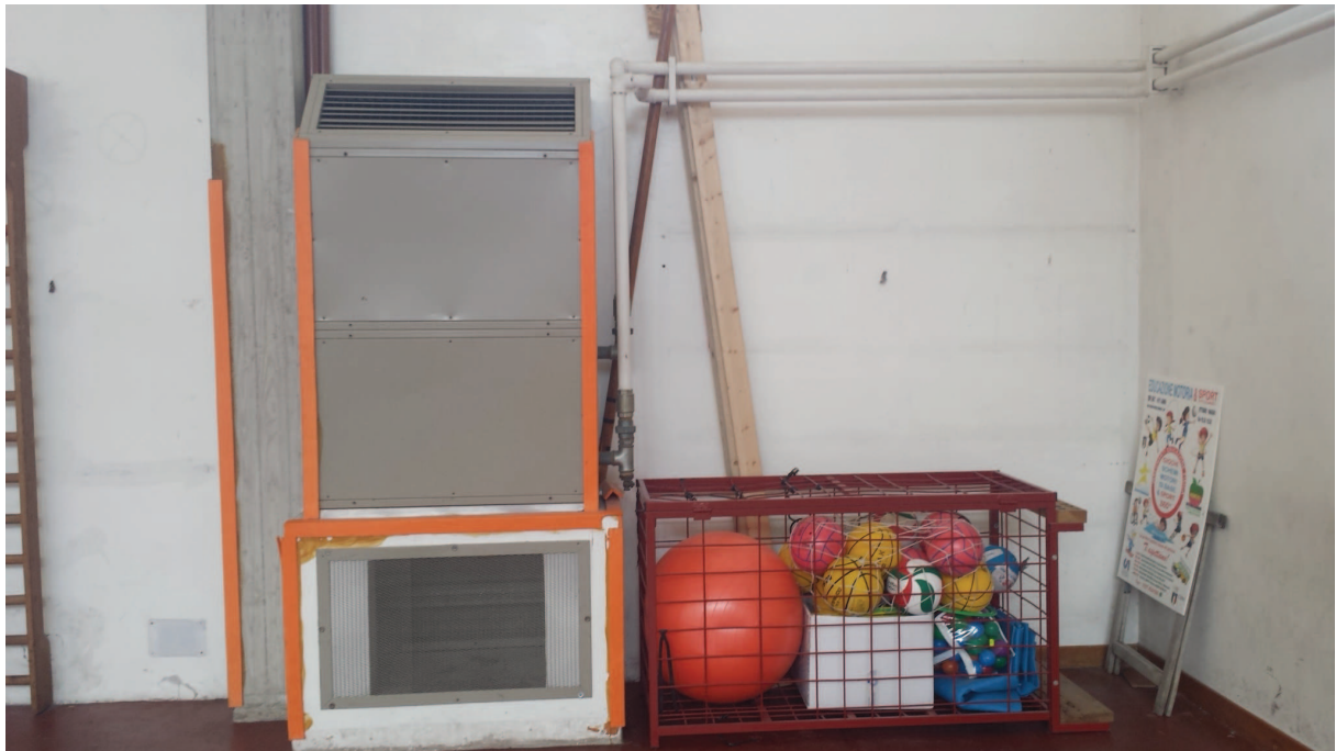
Presenza all'interno della palestra di vecchie apparecchiature di riscaldamento pericolose ed obsolete e le tubazioni degli impianti a vista privi di isolamento termico
