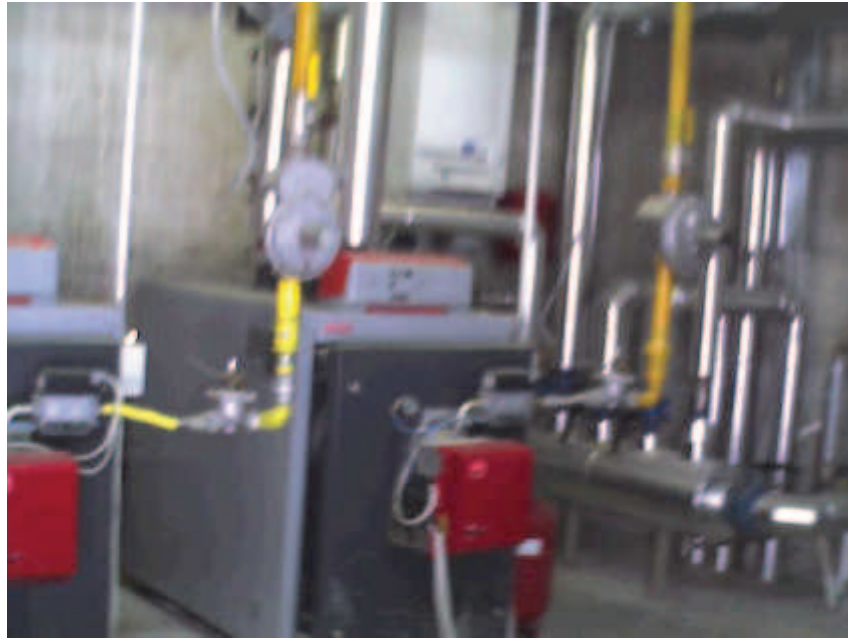
Foto 1a – caldaia in centrale termica -Immagine reale
